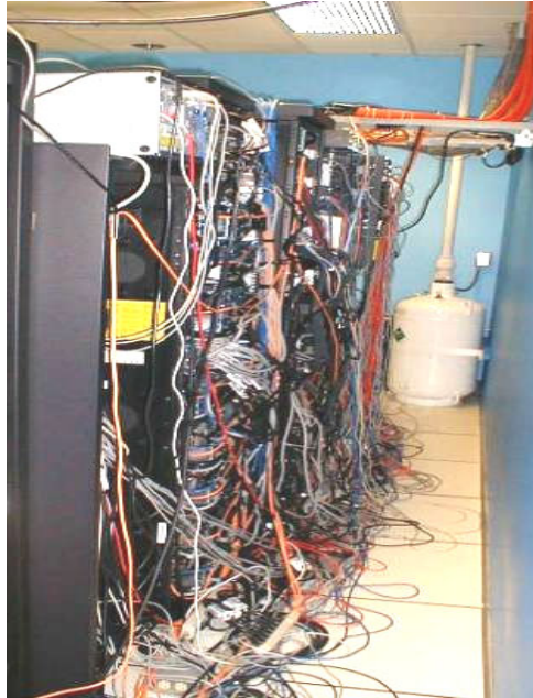
Abbildung 3 – Beispiel für ungeordnete Verkabelung
