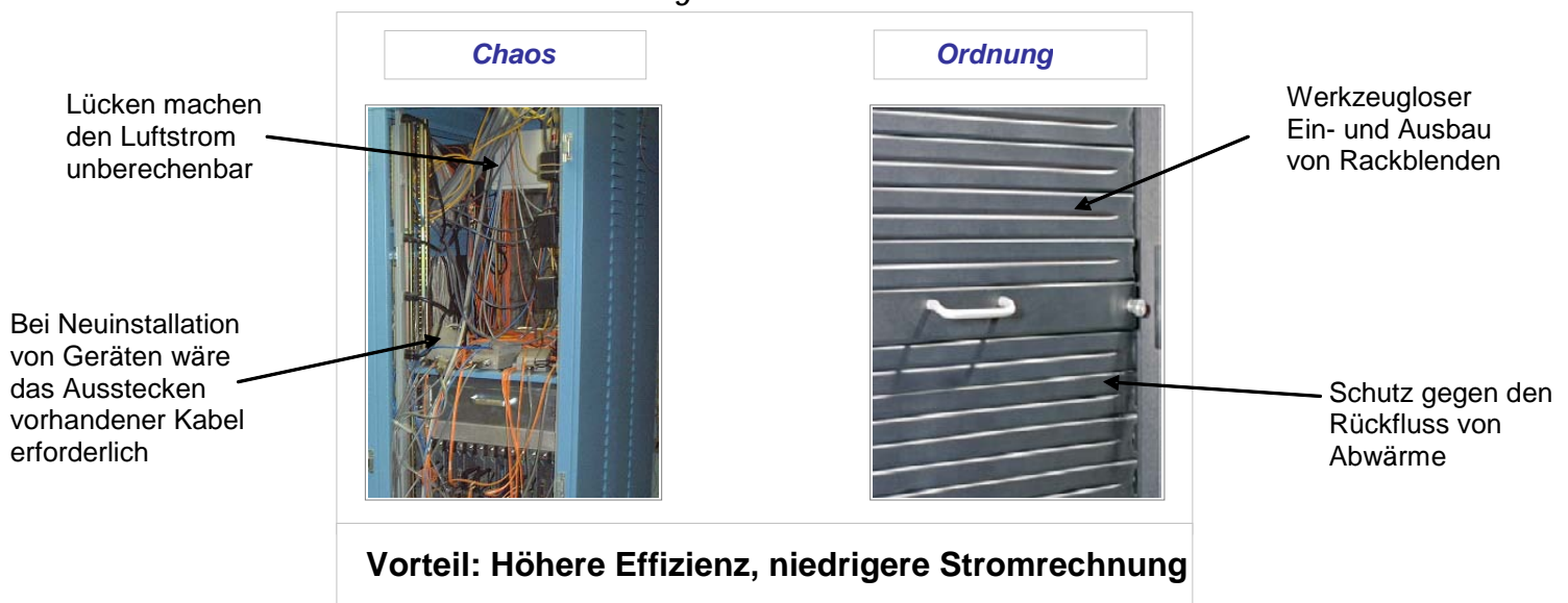
Abbildung 5 – Installation von Rackblenden
