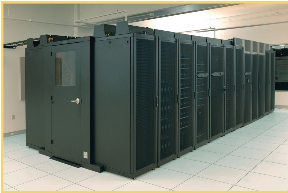
Abbildung 6 – Warmgangsystem zur Kühlung eines eigenständigen Bereichs
